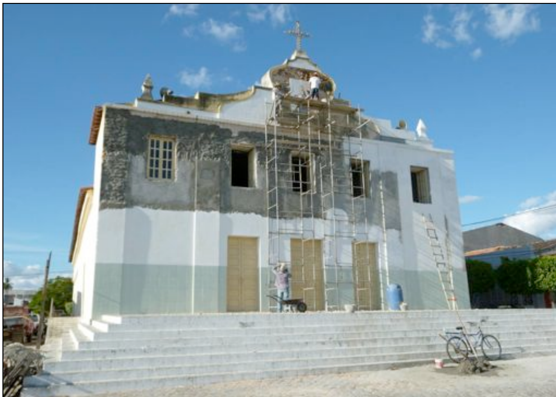
Imagem 08: Dilapidação dos painéis azulejares da Igreja Matriz de Tucano, 2012. Fonte: Jadd Pimentel
